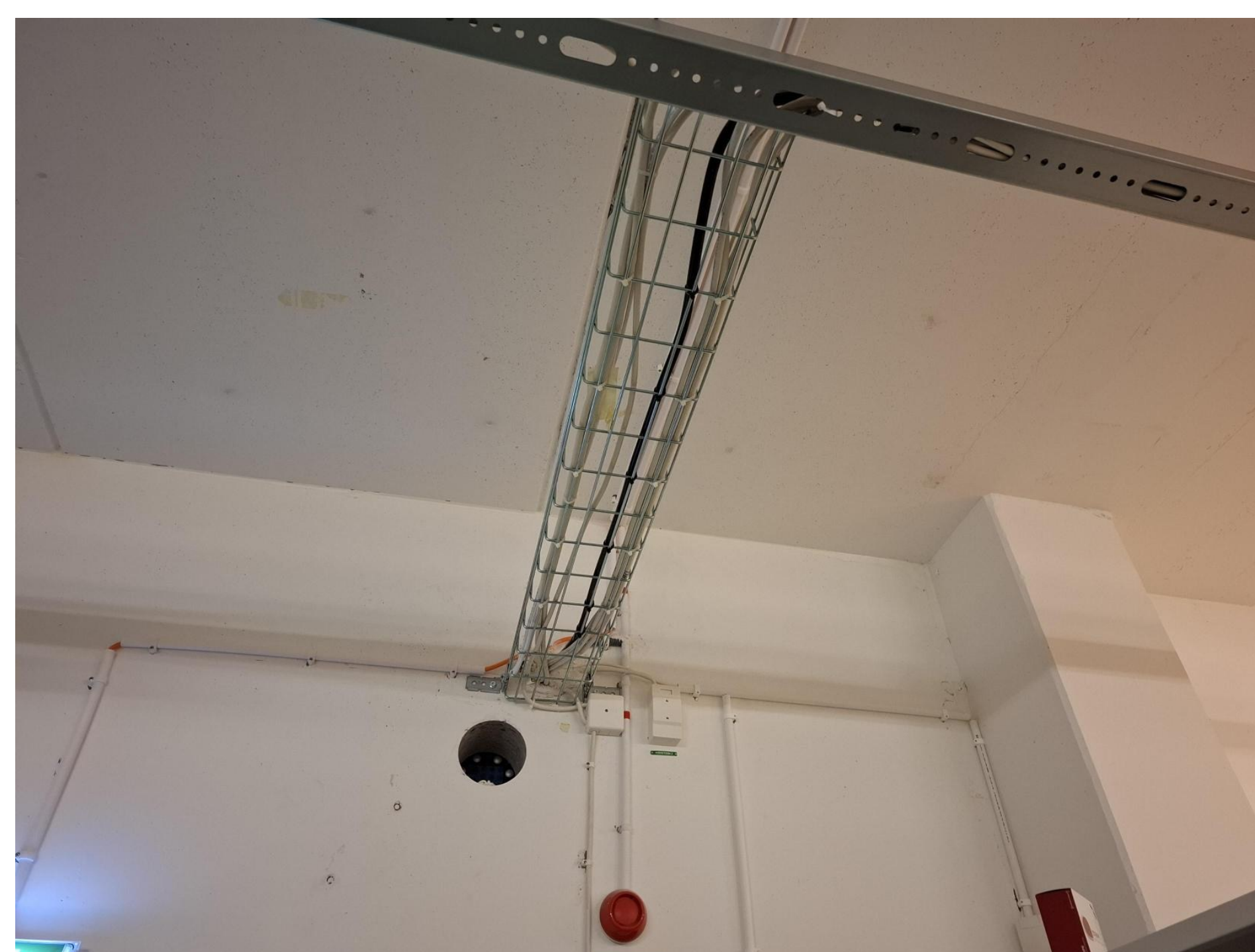
Elledningar och genomföring i centralarkivet, Ulls hus. Foto: Maria Sjölund
